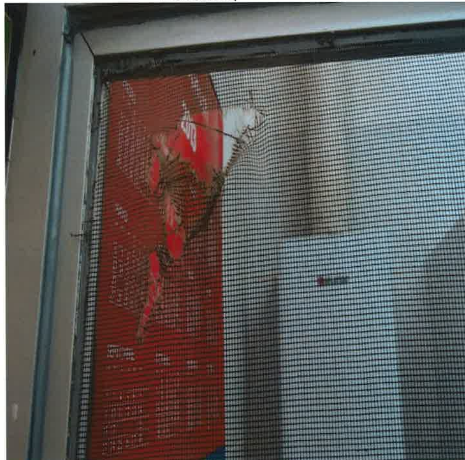
Jardín infantil Los Pecesitos; malla cocina en mal estado
