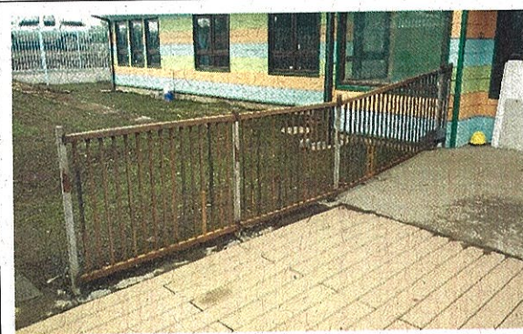
Fotografía N° 3: Rejas de acceso con óxido y no se ajustan a diseño de planos.
