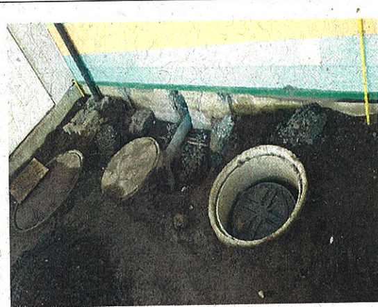
Fotografía N° 6: Cámara desgrasadora de PVC, no se ajusta a diseño de lámina 1 de 1 de proyecto de alcantarillado.
