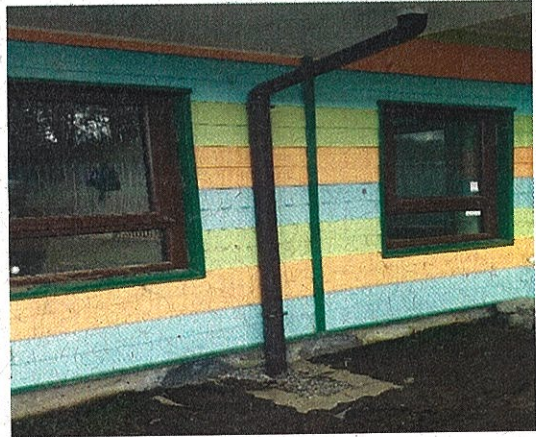
Fotografía N° 2: Dimensiones de dren no se ajusta a dimensiones exigidas en las especificaciones técnicas.
